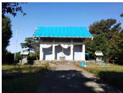
令和元年の台風で損壊してしまった社殿の 屋根(令和 2 年 10 月現在)
